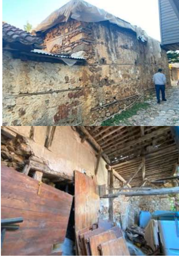
Şekil 10. Geleneksel evlerde bakımsızlık-Terk'e bağlı oluşan yapısal sorunlar ve bozulmalar
