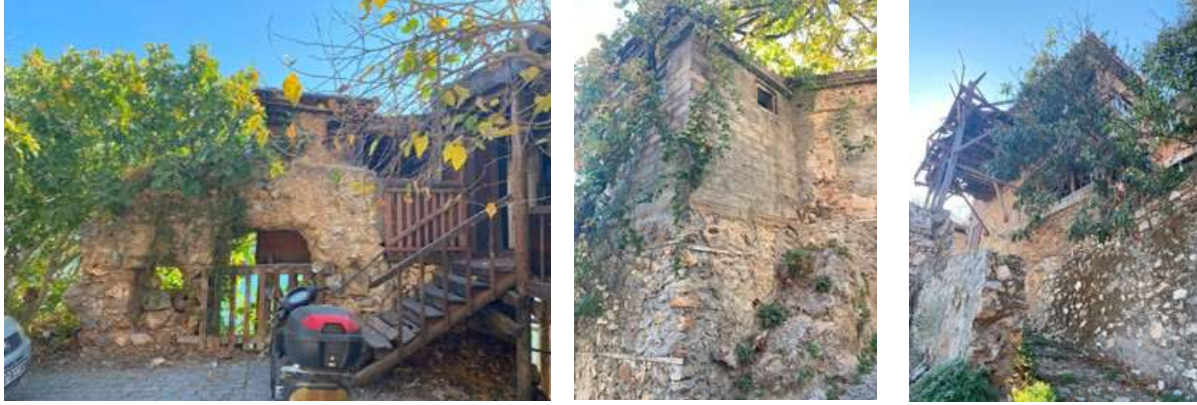
Şekil 8. Geleneksel evlerdeki doğa koşullarına bağlı oluşan yapısal sorunlar ve bozulmalar 2.5.2. Kullanıcılara Bağlı Oluşan Yapısal Sorunlar
