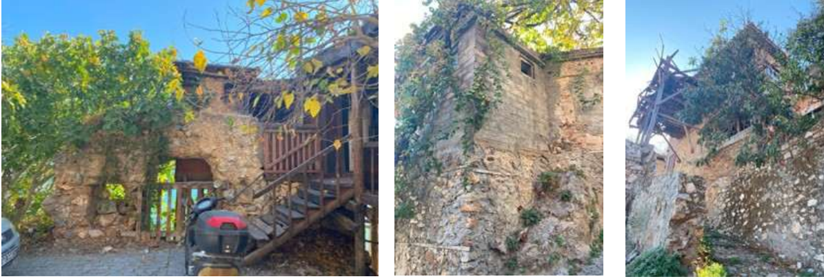
Şekil 8. Geleneksel evlerdeki doğa koşullarına bağlı oluşan yapısal sorunlar ve bozulmalar 2.5.2. Kullanıcılara Bağlı Oluşan Yapısal Sorunlar
