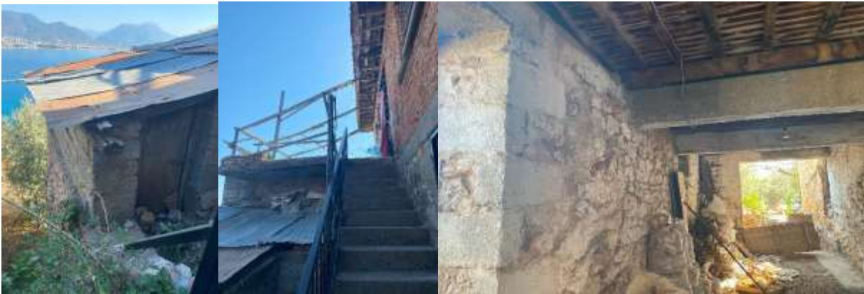
Şekil 9. Kullanıcılara bağlı niteliksiz malzeme ve betonarme kiriş eklenmesi (2025)
