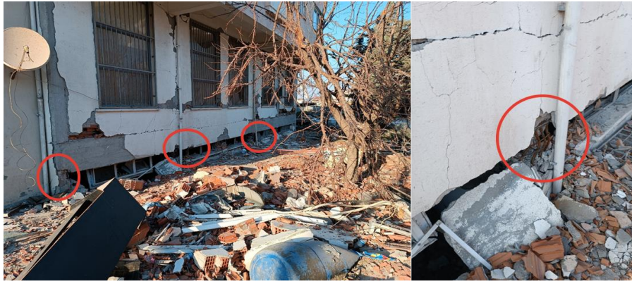
Şekil 3.5. Bant pencere kaynaklı oluşan kısa kolonlarda oluşan hasarlar
