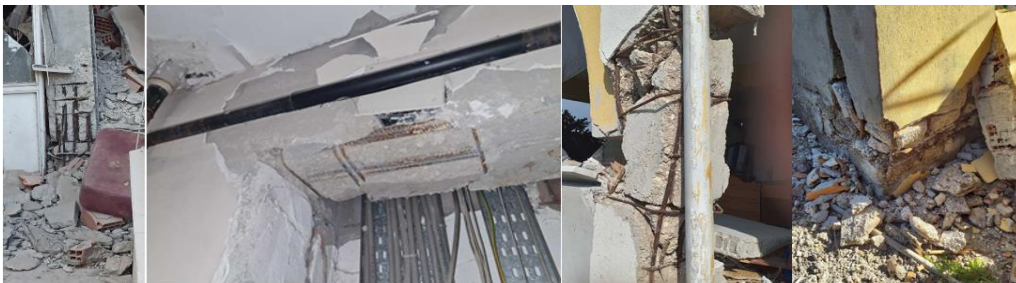
Şekil 3.6. Yetersiz beton örtü tabaka kaynaklı hasarlar
