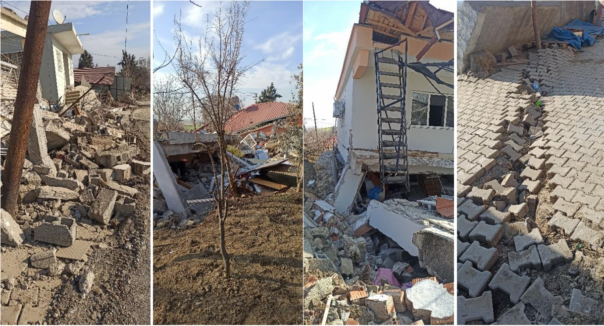
Şekil 8. Kuyumcular Köyü yapısal hasarları
