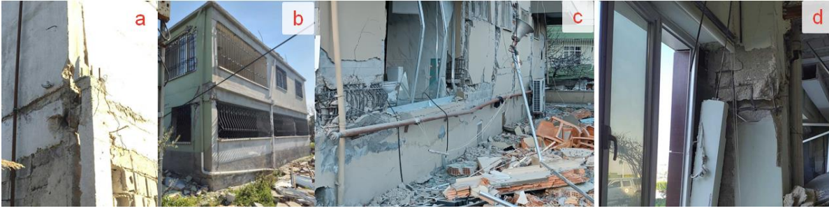
Şekil 3.4. Yetersiz enine ve boyuna donatı sonucu oluşan hasarlar: a)katlar arasında yetersiz donatı kenetlenmesi, b) Kolon-kiriş bölgesinde yetersiz enine donatı, c)Kolon alt sarılma bölgesinde yetersiz nine donatı, d) Kolon üst sarılma bölgesinde yetersiz enine donatı
