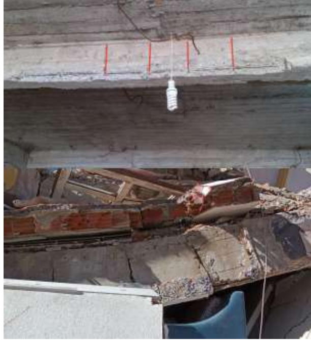
Şekil 1. Yetersiz enine donatı aralığı ve düşük dayanımlı beton kaynaklı hasar örnekleri
