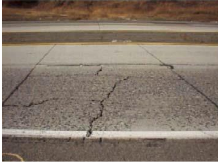
Şekil 3. Üçüncü seviye çatlak oluşumu ile şiddetli yüzey aşınması (Bautista ve Imad, 2008).
