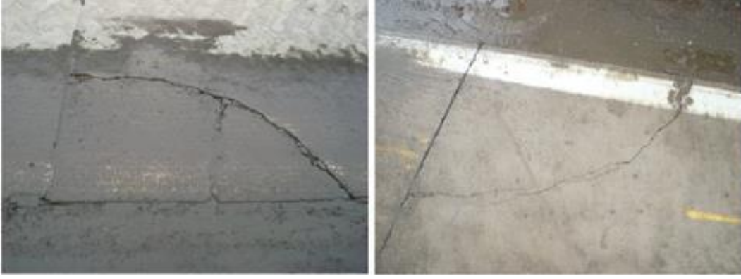
Şekil 5. Köşe çatlağı (Ceylan vd., 2015).
