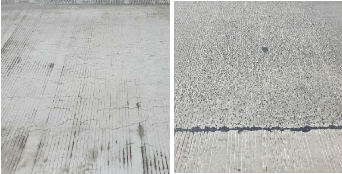
Şekil 2. Beton yol yüzeyindeki çatlak ve segregasyonlara örnek (Abadin vd., 2023).
