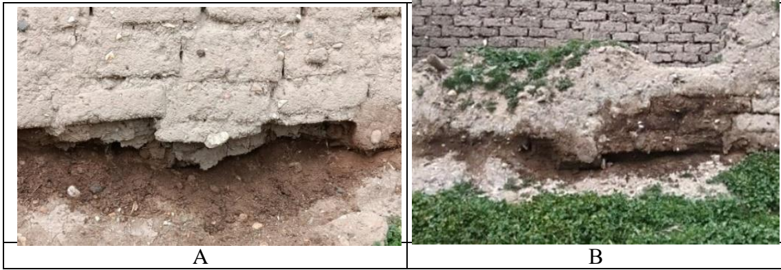
Şekil 3.6. 6 numaralı güvercin evinde (boranhane) meydana gelen hasarlar
