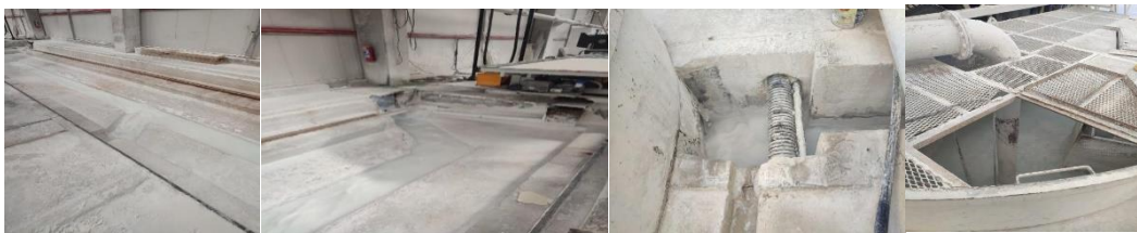
Şekil 5. Atık su depolama alanı
